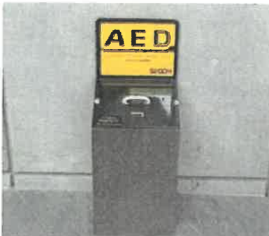
AEDの設置(設置場所確認)
